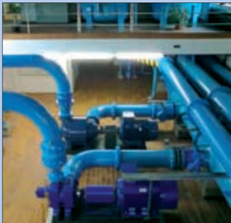
Rohrkeller im Wasserwerk
