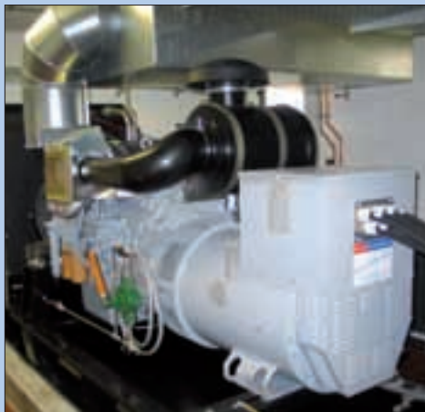
Notstromaggregat im Wasserwerk
