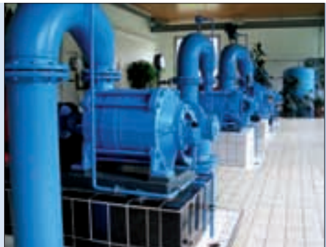
Pumpenhalle im Wasserwerk
